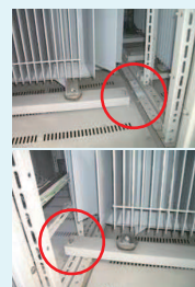
固定ボルト破損によるトランスの移動
