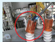
地震によりトランス端子部破損
