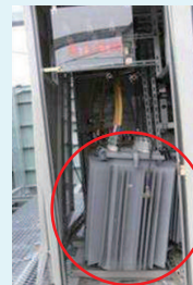
地震の衝撃によりトランスが側面に衝突し、側板と側面屏が変形
