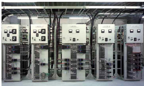
スーパー配電盤
